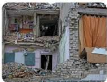
破壊された校舎
